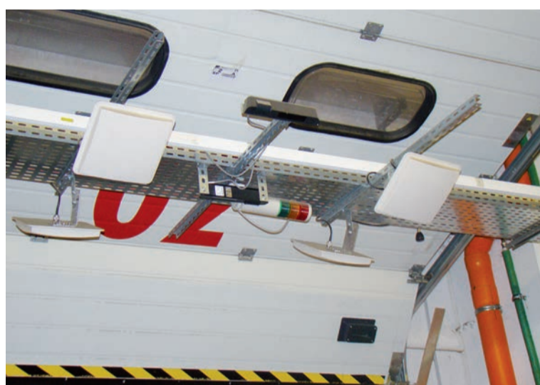
Foto 1 - L’hardware che sopra ogni baia controlla e certifica l’entrata/uscita delle Unità di Carico e dei colli, anche multi - destinatario: “qualunque pallet, qualunque roll transiti da una delle baie, non importa quale, non importa se in entrata o in uscita, viene letto e identificato dal sistema”
